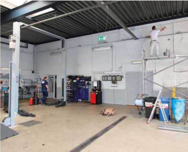
Op donderdag zijn de nieuwe bruggen geïnstalleerd. Dankzij de 5-tons tweekolommer is Van Tilborg beter voorbereid op bedrijfsauto's. Tijdens de verbouwing krijgt de werkplaats een nieuwe lak verf en ziet er daardoor weer fris uit.
